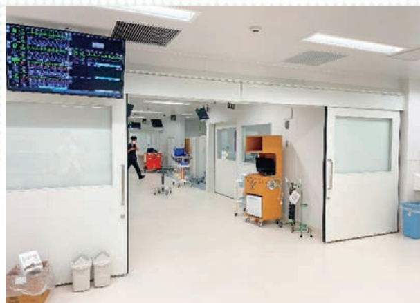
図4 一区画ごと陰圧室へ変更可能な集中治療室（扉奥の6床すべてが陰圧室となる）
